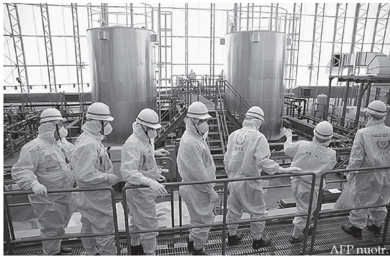
Fukušimo atominėje elektrinėje užfiksuotas dar vienas vandens nuotėkis.
